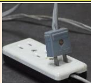
緩い差し込み
